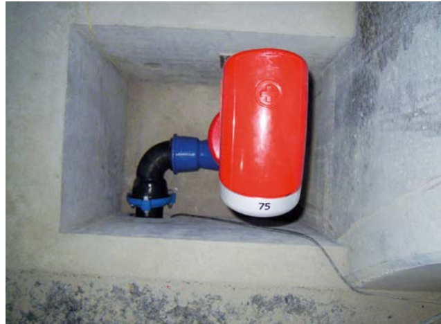
Fig. 13 Eingeengte Platzverhältnisse für die Installation der Hydranten
