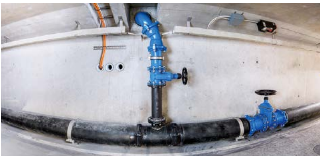
Fig. 4 Panoramabild der Löschwasserleitung im Werkleitungskanal mit Seitenabgang und Streckenschieber
