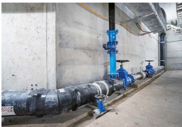
Fig. 15 vonRoll Armaturen im Einsatz: Streckenschieber, Absperrschieber für Stichleitungen sowie Anbohrarmatur als Entleerung
