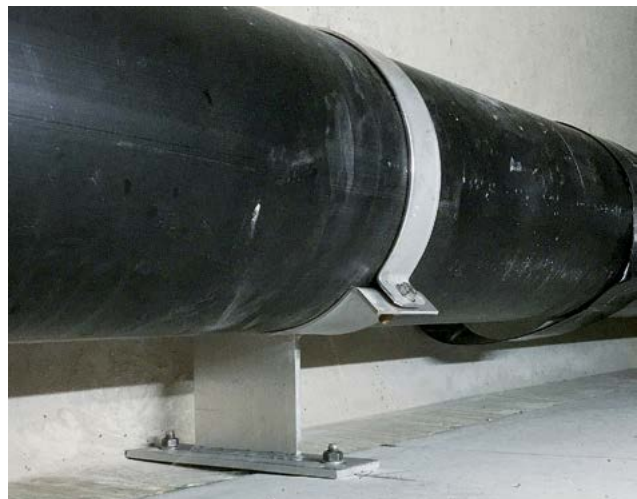
Fig. 6 Befestigung gedämmte Löschwasserleitung mit Standardrohrschellen
